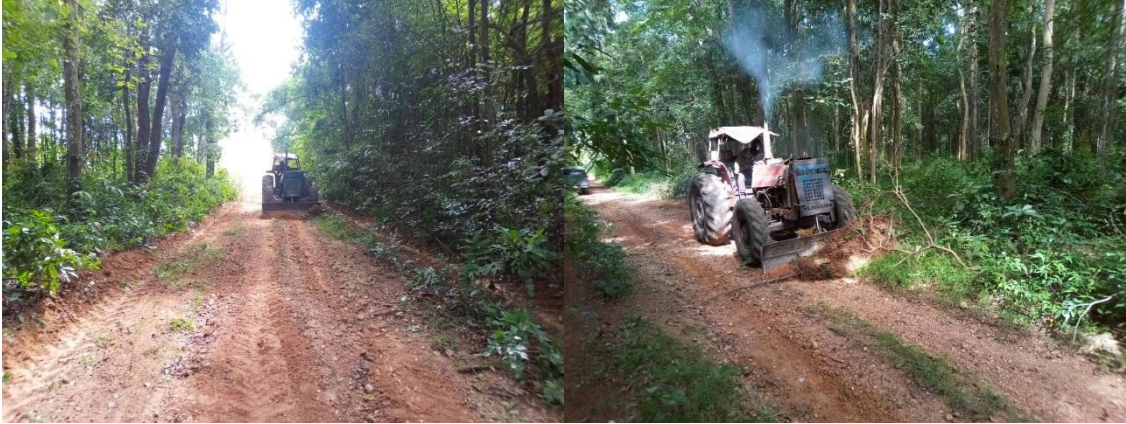
ภาพที่ ๑๑ ปรับปรุงซ่อมแซมเส้นทางตรวจการ และขอบเขตแปลงโครงการฯ ของสวนป่าคลองตะเกรา
